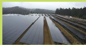
⑥棚倉堂ノ沢発電所 (2678kW)
