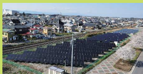
②鏡石旭町第一・二・三発電所 (157kW)
