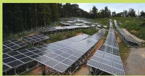
⑤矢吹中丸発電所 (739kW)
